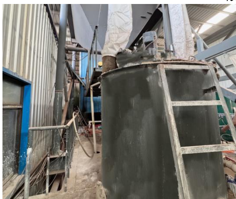
自动加石灰石罐
