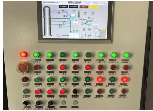
全自动脱硫、加石灰石一体化控制系统
