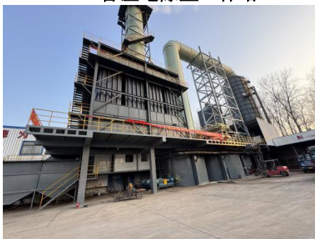
脱硫湿电一体化设备
