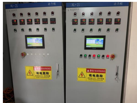
湿电电源控制柜
