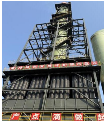
640管湿电除尘一体塔
